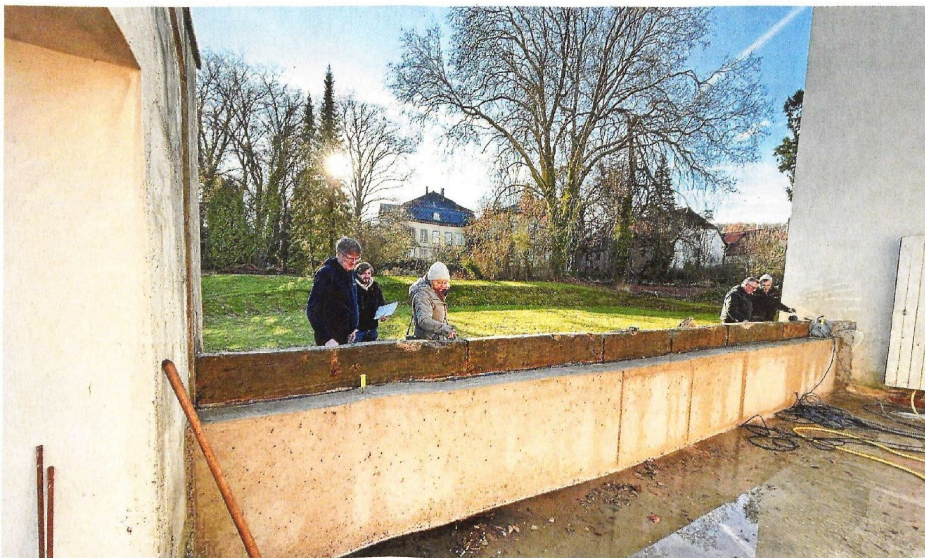
Vom dem östlichen Glashaus ist nur eine Mauer geblieben. Wie es hier weitergehen soll, beraten Firmenchef Ralf Schmalstieg (von links), Architekt Jan Faltz und Ruth Buchholz.
