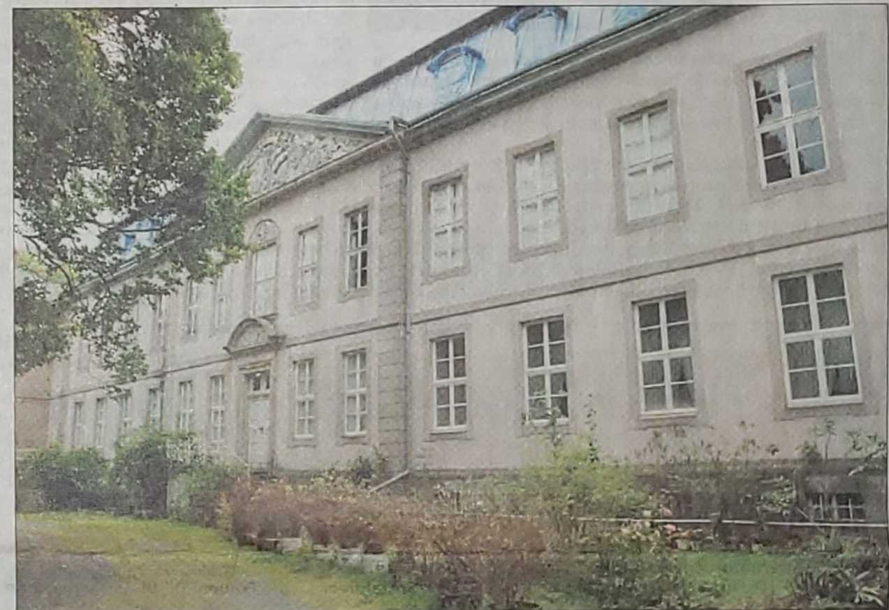
So sieht das Schloss aus dem Jahr 1740 heute aus. Das Dach ist gerade erst mit blauen Plastikplanen gegen eindringende Nässe geschützt worden.
