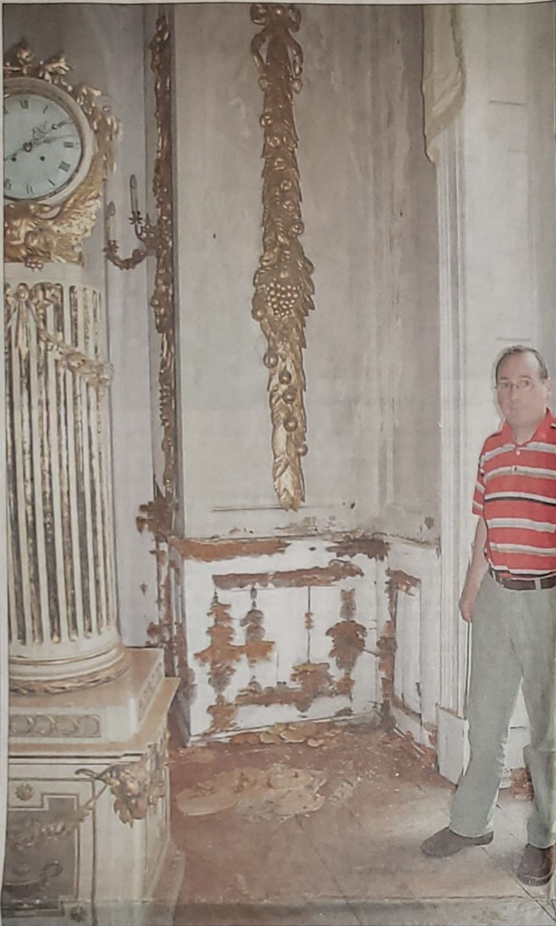
Eindringende Feuchtigkeit hat dazu geführt, dass die Wände im Schloss im Laufe der Jahre mit Schimmel befallen wurden. Besondere Sorge bereitet Alexander Graf von Goertz-Wrisberg der braune Hausschwamm, der auch den weißen Saal zerstört. Fotos: Deutkens
